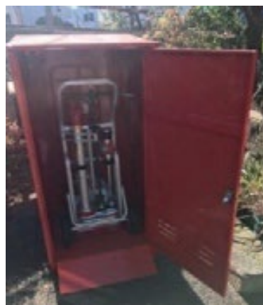
初期消火器具を収納する初期消火箱
